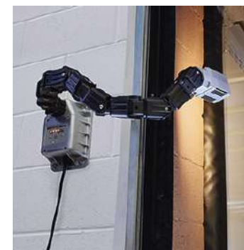
LUCES DEL MUELLE DE CARGA
