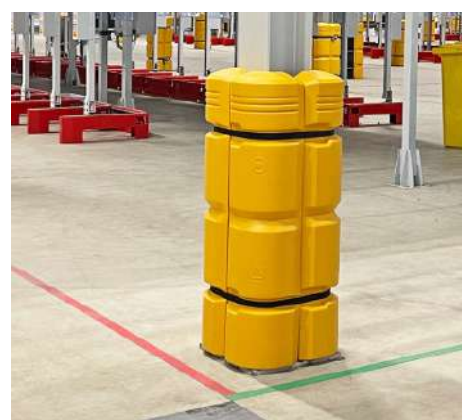
PROTECCIÓN DE COLUMNA
